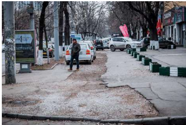
Imaginea 27 - Starea actuală a trotuarelor din Chișinău
