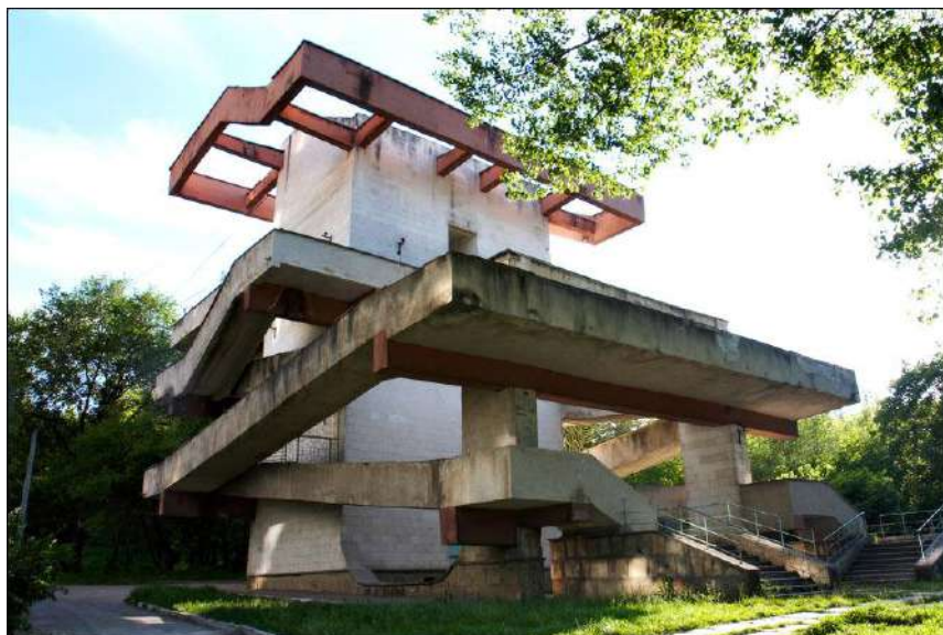
Imaginea 75 - Starea actuală a telecabinei (stația inferioară)
